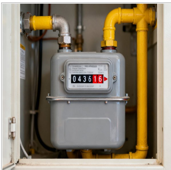
Compteur de gaz
